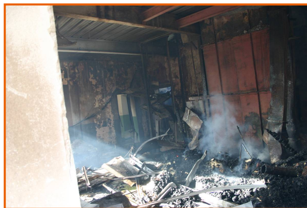
Area del silos-fariniera, del montacarichi e dell'ufficio con la bilancia al piano terra del corpo centrale del mulino
