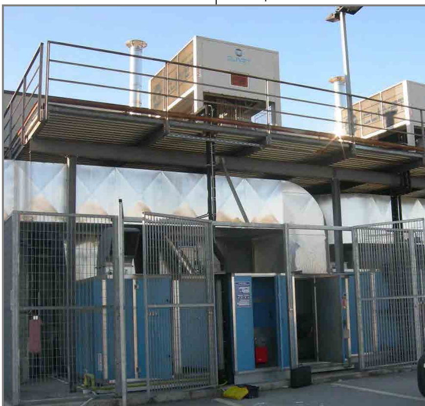
Unità Trattamento Aria
